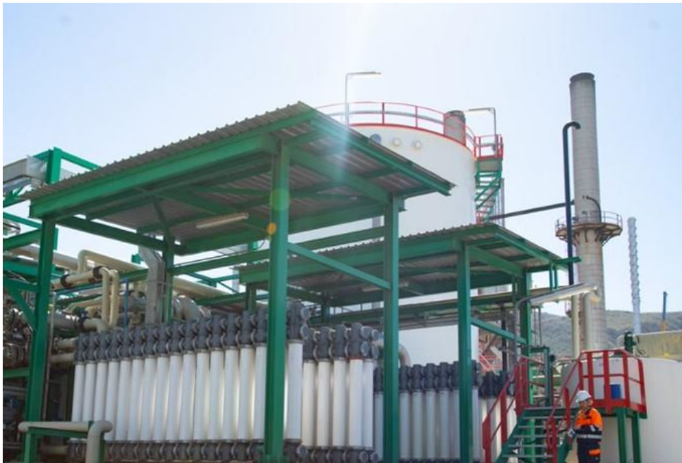
Nueva planta de Ultrafiltración. Refinería de Cartagena
